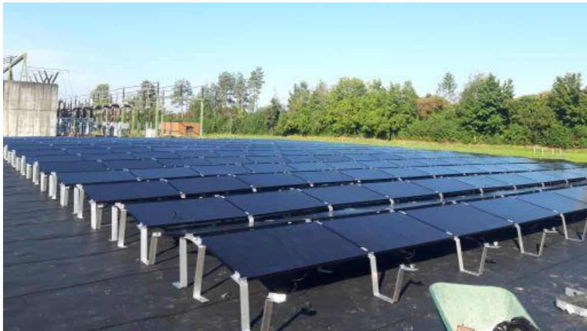
Abbildung 17: 350 kW Anlage auf dem Unterwerk der Axpo in Altgass, Gemeinde Baar (Bild: © Axpo).
