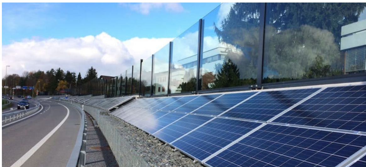
Abbildung 4: 2014 wurde durch das Tiefbauamt des Kantons Zürich an der Forchautobahn auf 300 Metern Lärmschutzwand eine PV-Anlage installiert, Betreiber ist Zürichsee Solarstrom AG (Bild: © Tiefbauamt Baudirektion Kanton Zürich)
